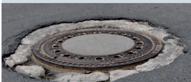
BILD 2: Typische Mängel bei eingebauten Schachtabdeckungen
