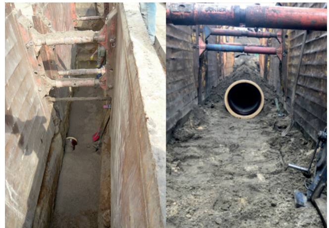
Abb. 1: Unsachgemäß bzw. fachgerecht: Die extreme Abweichung zwischen Rohr- und Verbauachse macht eine fachgerechte Herstellung der Bettung und der Zwickelverdichtung nicht möglich (l.). Einbau des Rohres mit beidseitig gleichem Arbeitsraum gemäß Regelwerk (r.).
