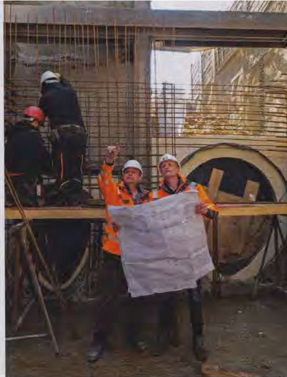
Ein wichtiger Bestandteil der Gütesicherung Kanalbau sind die von den Prüfingenieuren durchgeführten Baustellen- und Firmenprüfungen. Zurzeit überprüfen 28 Prüfingenieure bundesweit sowie im benachbarten Ausland die Qualifikation der Gütezeicheninhaber.
