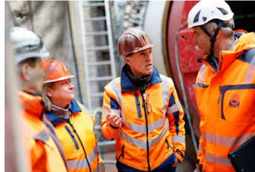
Baubesprechung vor Ort: Reinhard Lang (Mitte) erläutert die aktuellen Vortriebsarbeiten. V.l.n.r.: Christian Trittenbach, Oberbauleiter Sonntag Baugesellschaft mbH & Co. KG, Miriam Liß, Projektleiterin SUN und Dieter Walter, Prüflingenieur Güteschutz Kanalbau.
