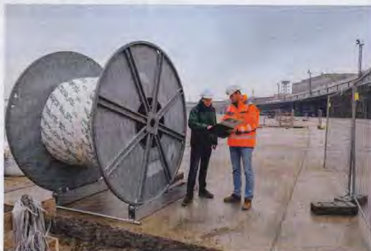
Die Arbeit der vom Güteausschuss beauftragten Prüfsingenieure trägt dazu bei, dass Erfahrung und Zuverlässigkeit der Unternehmen bewertbar gemacht werden. Foto: Güteschutz Kanalbau
