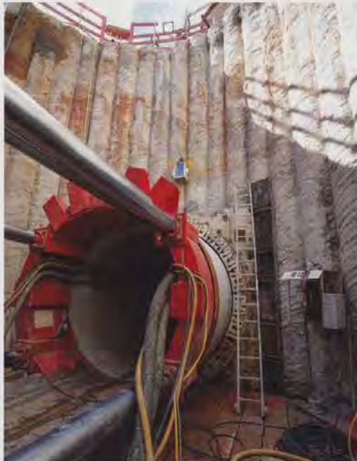
Bild 3: In rund 11 Meter Tiefe finden die Arbeiten zum Bau des Stauraumkanals statt.
