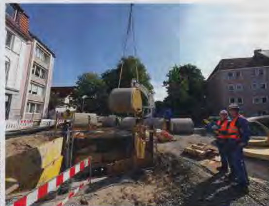
Die GFK-Rohre werden in der Baugrube mit einem Fahrwagen in die Lutter-Verrohrung eingefahren. Alexander Garen (Umweltbetrieb der Stadt Bielefeld, rechts) und Prüfingenieur Guido Heidbrink (Güteschutz Kanalbau, links) besprechen den Sanierungsfortschritt.
