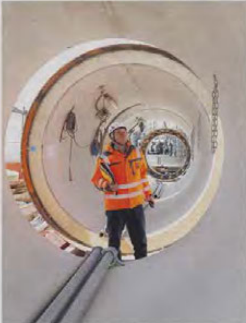
Während einer Baustellenprüfung nimmt Prüflingenieur Dieter Walter von der Güteschutz Kanalbau auch die Vortriebsrohre in Augenschein.
