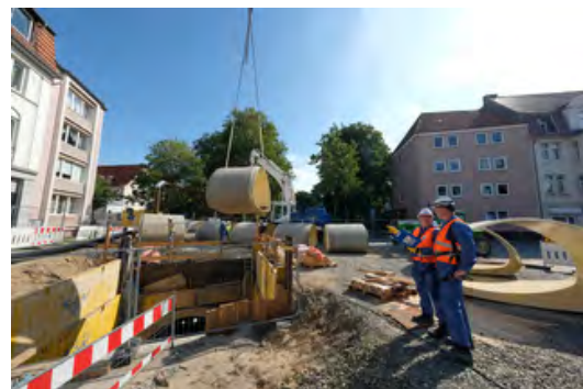
Die GFK-Rohre werden in der Baugrube mit einem Fahrwagen in die Lutter-Verrohrung eingefahren. Alexander Garen (Umweltbetrieb der Stadt Bielefeld, rechts) und Prüffingenieur Guido Heidbrink (Güteschutz Kanalbau, links) besprechen den Sanierungsfortschritt.
