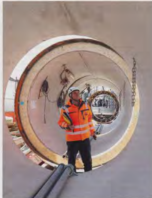
Bild 4: Während einer Baustellenprüfung nimmt Prüflingenieur Dieter Walter, Güteschutz Kanalbau, auch die Vortriebsrohre in Augenschein.
