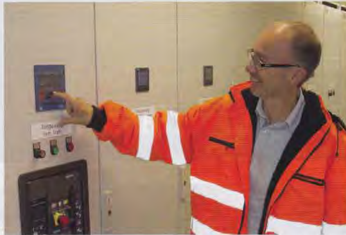
Horst Wagner zeigt: Über das Energiemanagement-System werden die einzelnen Komponenten der Kläranlage so gesteuert, dass die Anlage netzdienlich arbeitet. | Foto: Güteschutz Kanalbau
