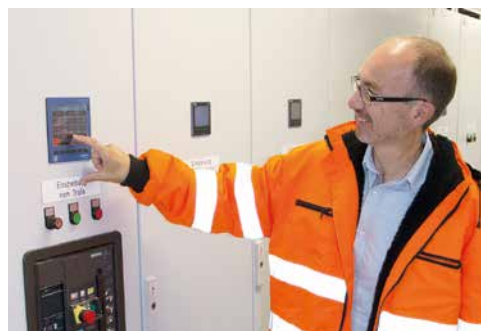
Bild 3 Über das Energiemanagementsystem werden die einzelnen Komponenten der Kläranlage so gesteuert, dass die Anlage netzdienlich arbeitet. Quelle: Güteschutz Kanalbau
