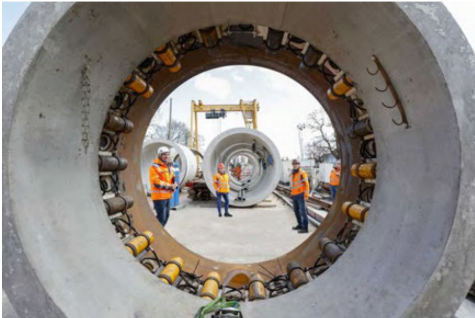
Bei dem zweiten Vortrieb kommen fünf Zwischenpressstationen zum Einsatz. | Foto: Güteschutz Kanalbau
