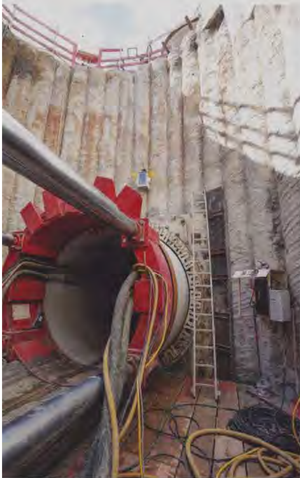
In rund 11 m Tiefe finden die Arbeiten zum Bau des Stauraumkanals statt.
