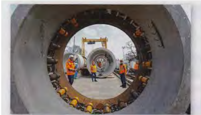
78 Beim Bau eines Stauraumkanals in Nürnberg kommen unter erschwerten Bedingungen bei einem Vortrieb fünf Zwischenpresstationen zum Einsatz
